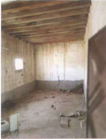
مكان مولدات الكهرباء (المرحلة الثانية)
